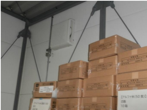
倉庫内換気扇
