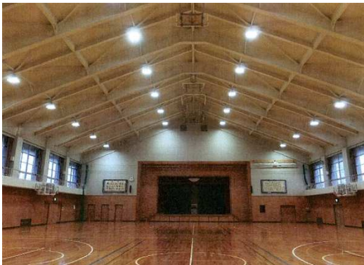
照明器具のLED化
