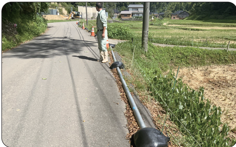
上藤又配水管破損は既決予算内で応急措置
