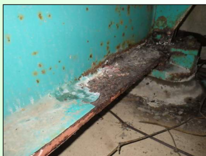
鋼橋の主桁の腐食
