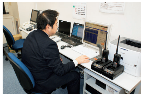
デジタル防災行政無線司令室
