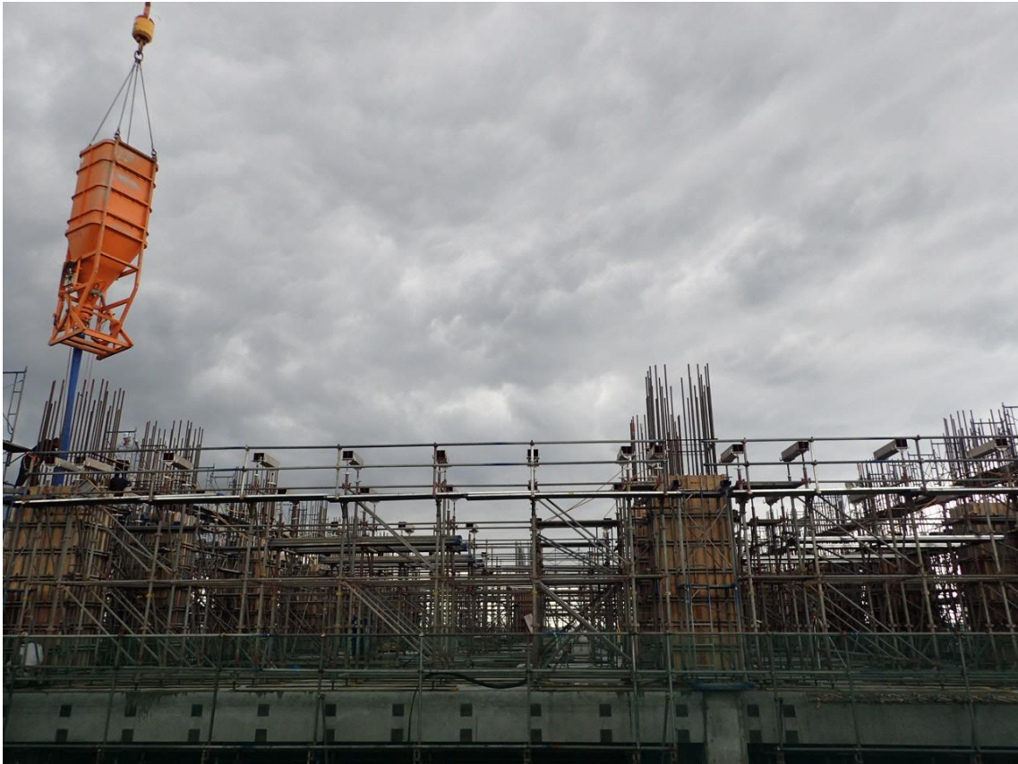
令和2年6月19日 3階柱部分のコンクリート打設を行っています。
