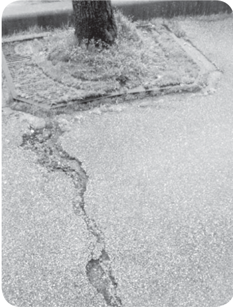
▲街路樹によりひび割れした歩道
