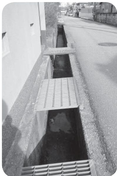
▲転落防止対策が望まれる
