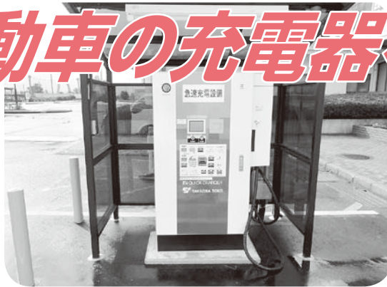
▲設置されている充電設備 (内灘町)
