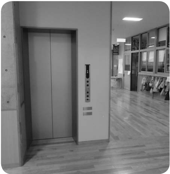
▲設置されている津幡小学校
