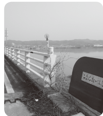
▲さらなる補強を (湖南大橋)
