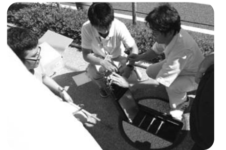
▲マンホールをトイレに（岡崎市）
