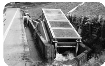
▲用水を利用した発電 (石徹白マイクロ水力発電施設)
