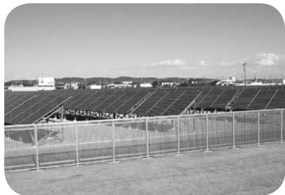
▲ズラリと並ぶ太陽光パネル（富山太陽光発電所）
